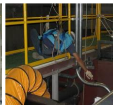
廢水處理開放槽
