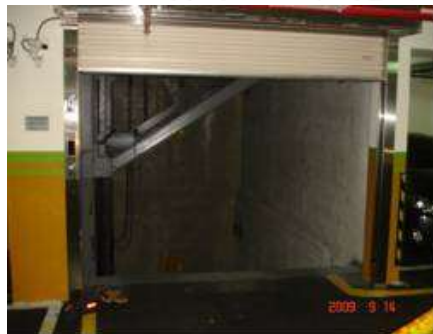
地下2樓 (B2) 停車設備外觀
